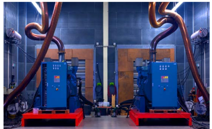
Diesel USV im Prüffeld Bilshausen
