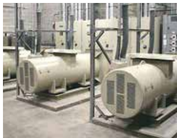
Zentrale 400Hz Versorgung mit Piller Motor-Generator-Sets.
