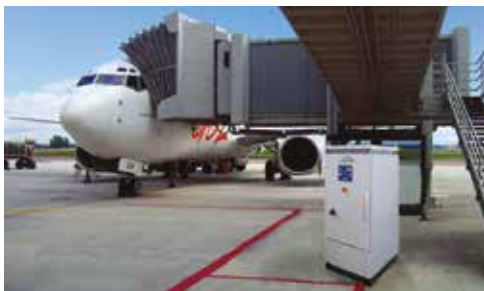
Piller Bodenstromversorgung mit statischem Umformer.
